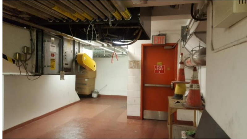
Şekil 6 - Acil durum dedektörleri, havalandırma, aydınlatma ve ekipmanları
